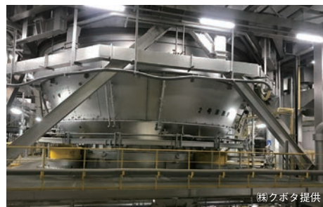
（株）クボタの熔融炉。 大きさは外径11m、高さ6m程度。
