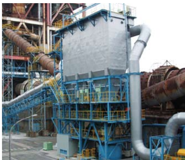
荻田工場の高塩素バイパス設備
