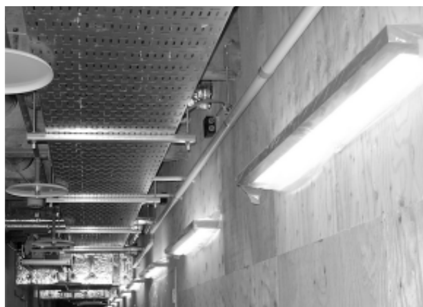
日本政府館の内部に施工されたリサイクル塩ビ管
