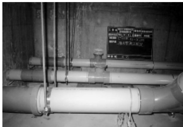
1階ピット下の排水用横主管
