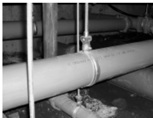
都営高井戸西一丁目アパートの施工状況(1階床下の横主管)
