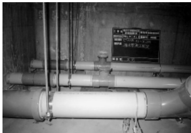
1階ピット下の排水用横主管
