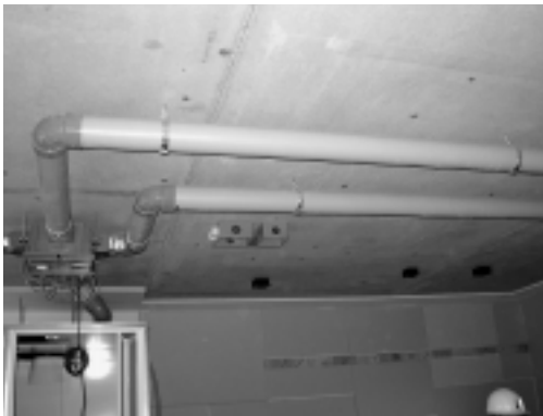
住戸内天井の換気用ダクト
