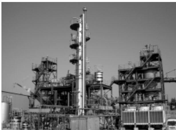
脱塩素設備の全景
