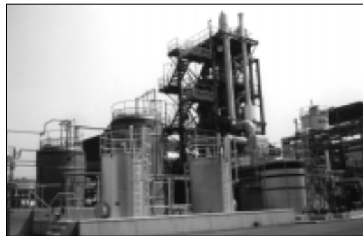
実証プラント全景
